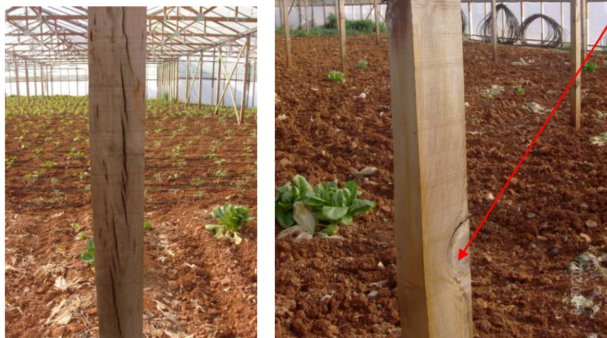
Εικ. 18-19. Εξετασθέντες ορθοστάτες (ραγαδώσεις έντονες – τεράστιοι ρόζοι)
