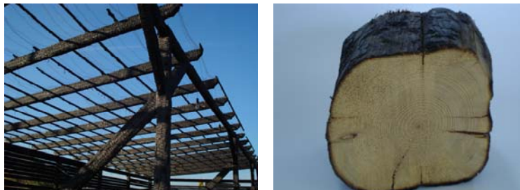
Εικ.1. Ξύλινο υπόστεγο μετά από πυρκαγιά (αριστερά). Οι δοκοί διατηρούν την ακεραιότητά της κατασκευής (δεξιά). (Φωτογραφίες: I. Κακαράς)
