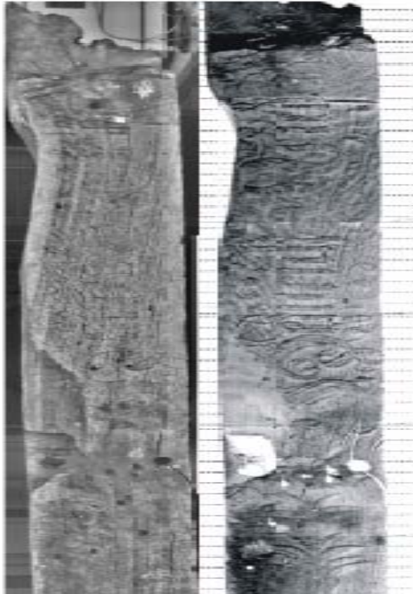
Εικ. 3. Υπέρθρη θερμογραφία ξύλινης δοκού κτιρίου, που αποκαλύπτει την υποβάθμιση της ξυλόγλυπτης παράστασης (Brocke 2007).
